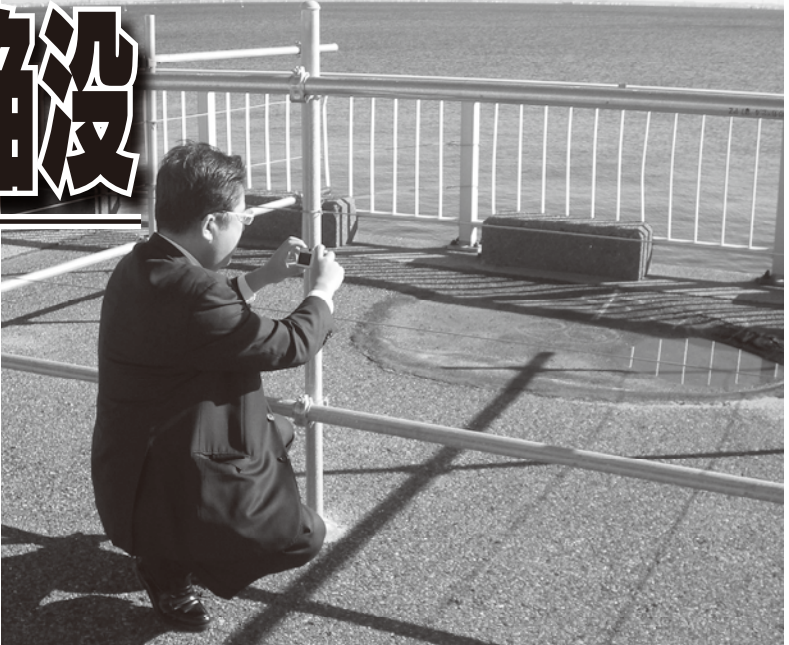
高洲海岸の護岸の陥没部分
