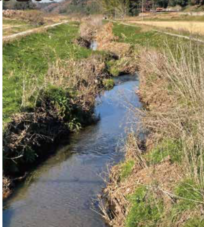
堆積土砂の浚渫が必要な根木名川
